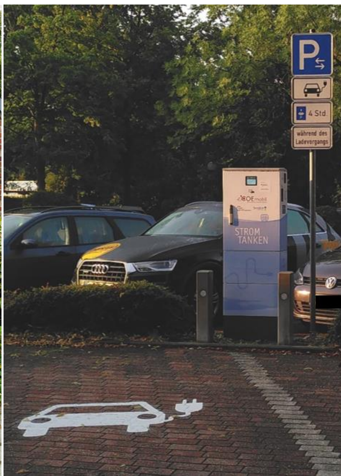
Abb.: Ladesäule in Senden, Anton-Aulke-Ring
